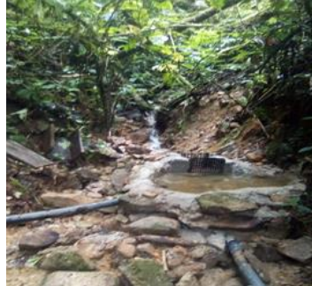
Figura 1 Toma de Agua
